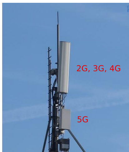
Slika 2: Prikaz antenskega stolpa na poslovni stavbi, kjer se na isti lokaciji nahajata bazna postaja obstoječega omrežja 2G, 3G in 4G ter nova bazna postaja omrežja 5G.
